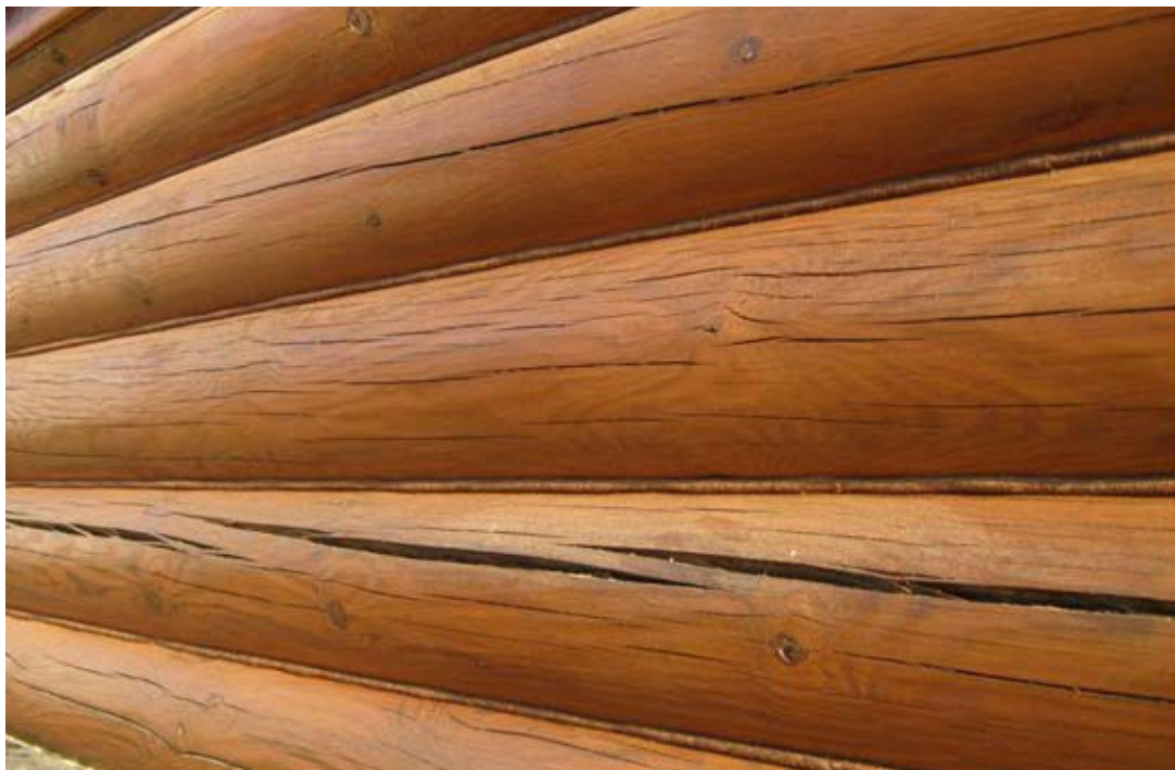
Рисунок 51 – Трещины на срубе из сосны ( http://tot-dom.ru )
